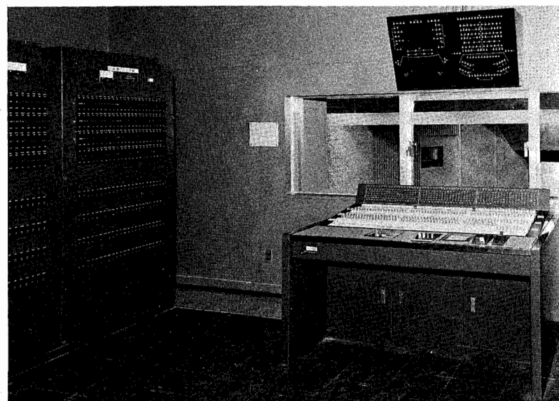
照明操作卓と負荷モニター盤
